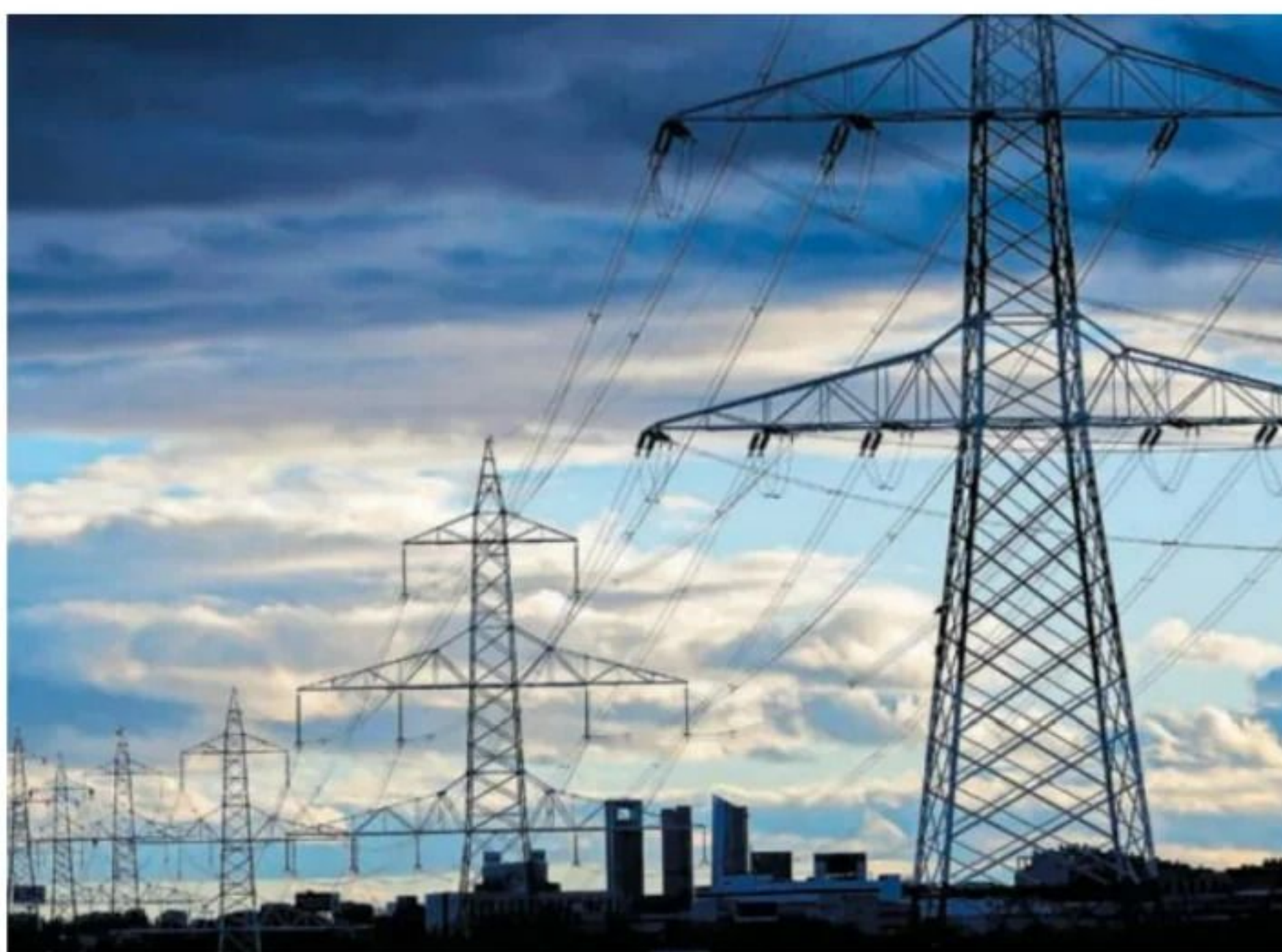
Tendido eléctrico en San Sebastián de los Reyes (Madrid). LUIS SEVILLANO
